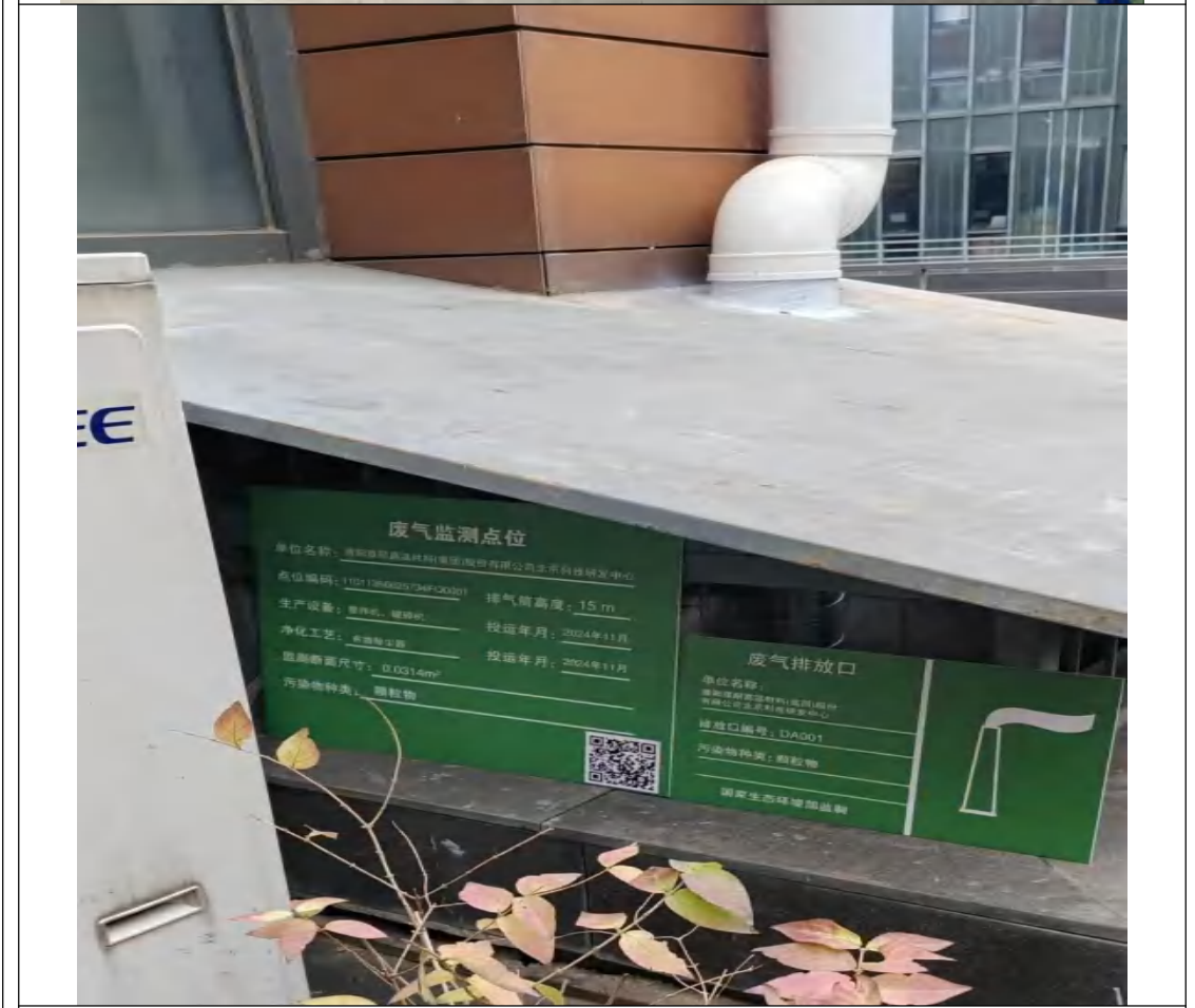
集气罩、除尘机组以及废气排放口照片
